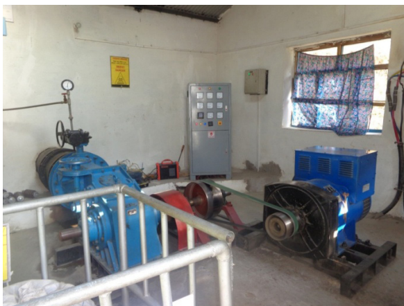
EM Parts inside Power House
